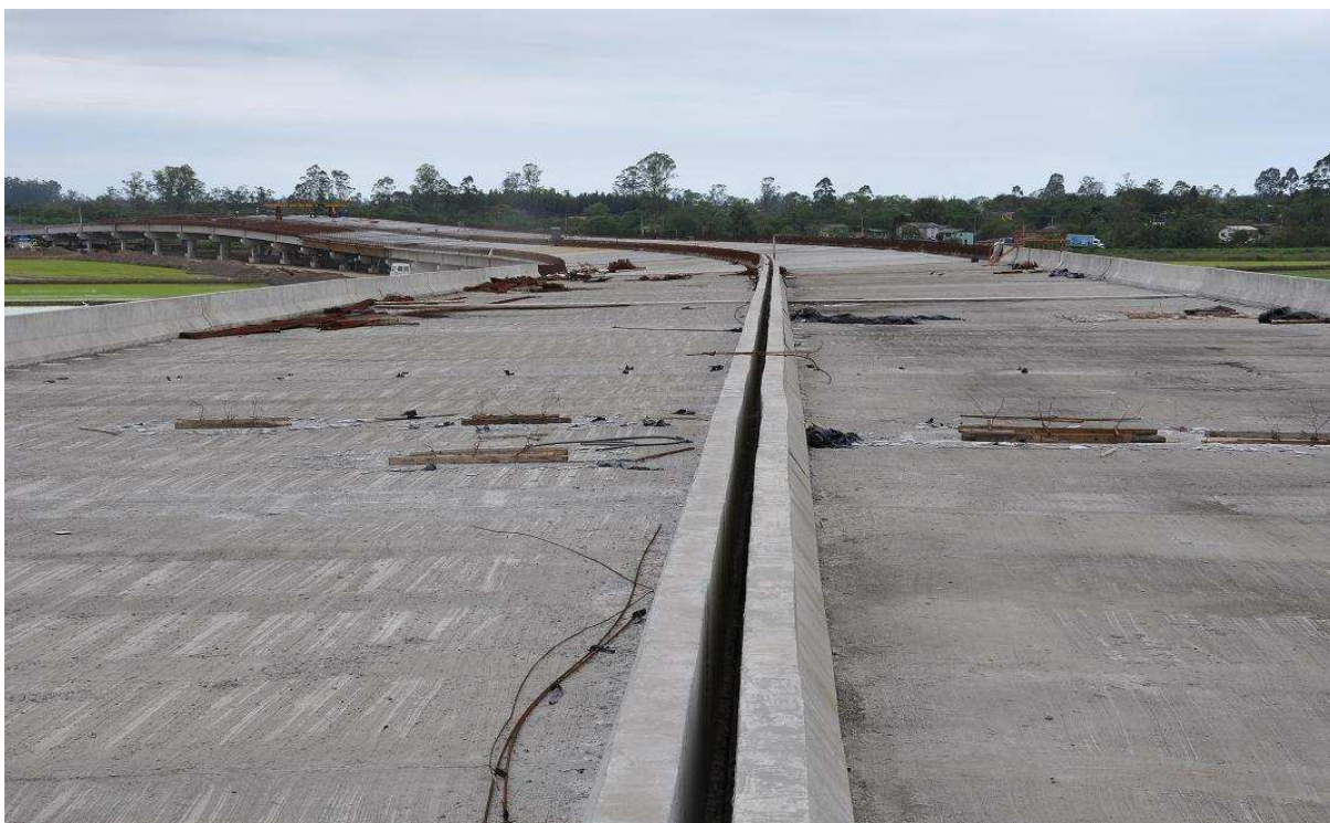
Figura 32: Obras do elevado sobre os banhados no Desvio pela Vida, outubro de 2011.
